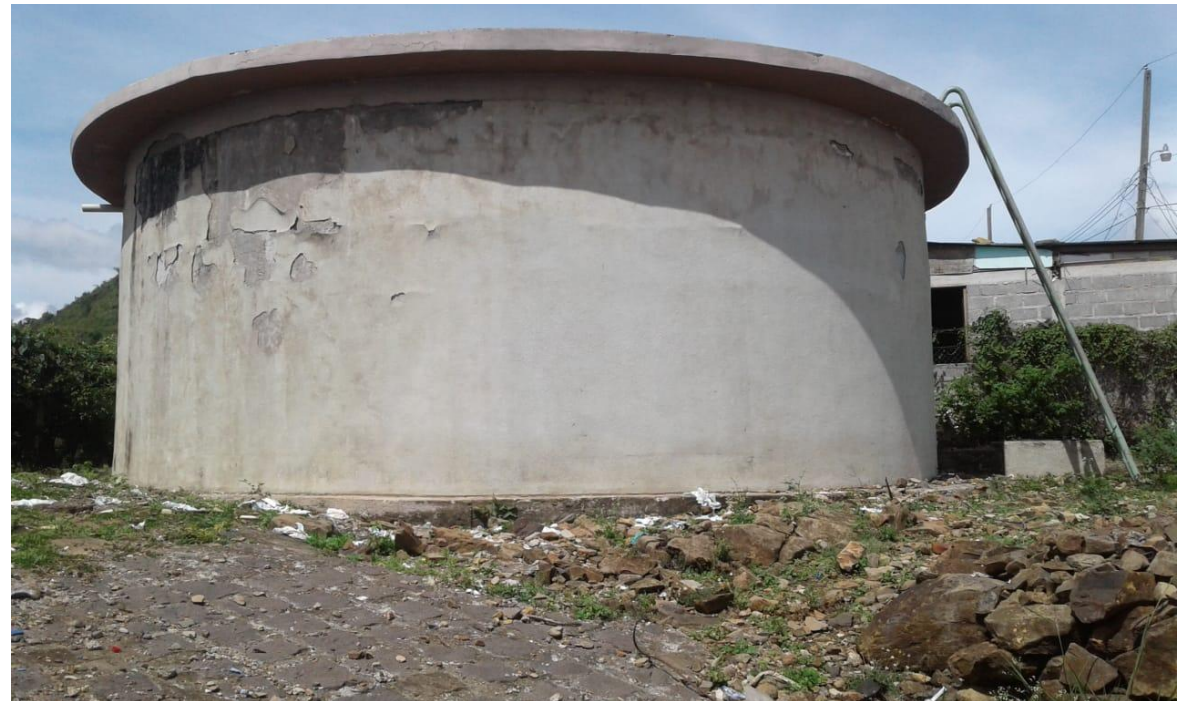
Tanque de Distribución del sistema de agua potable en colonia Nueva Galilea.
