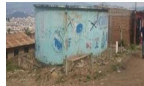
Tanque de Distribución del sistema de Agua Potable, Colonia 25 de Enero.
